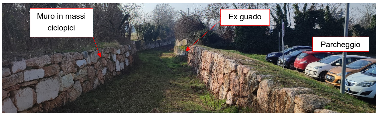
Figura 16: Argini in corrispondenza del parcheggio di via della Consortia
